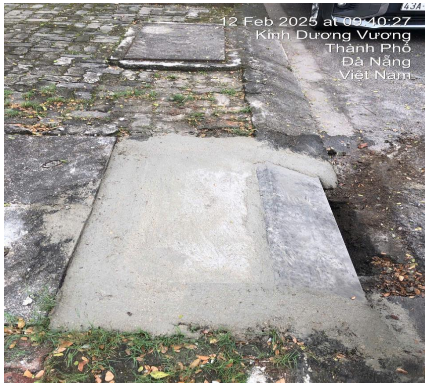
Hình ảnh sau xử lý bó vỉa bị hỏng gần số nhà 555 đường Kinh Dương Vương
