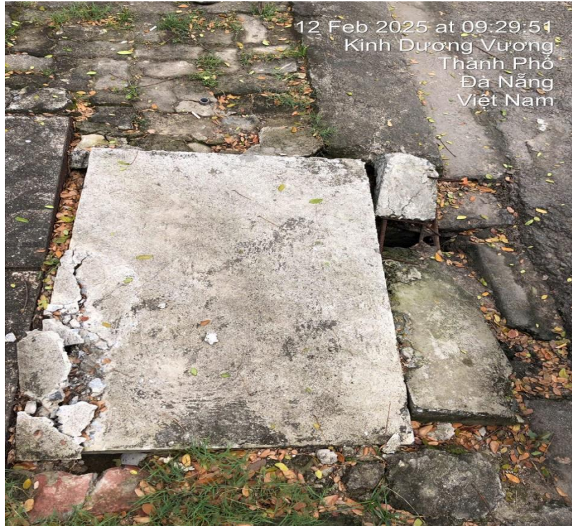
Hình ảnh trước xử lý bó vỉa bị hỏng gần số nhà 555 đường Kinh Dương Vương
