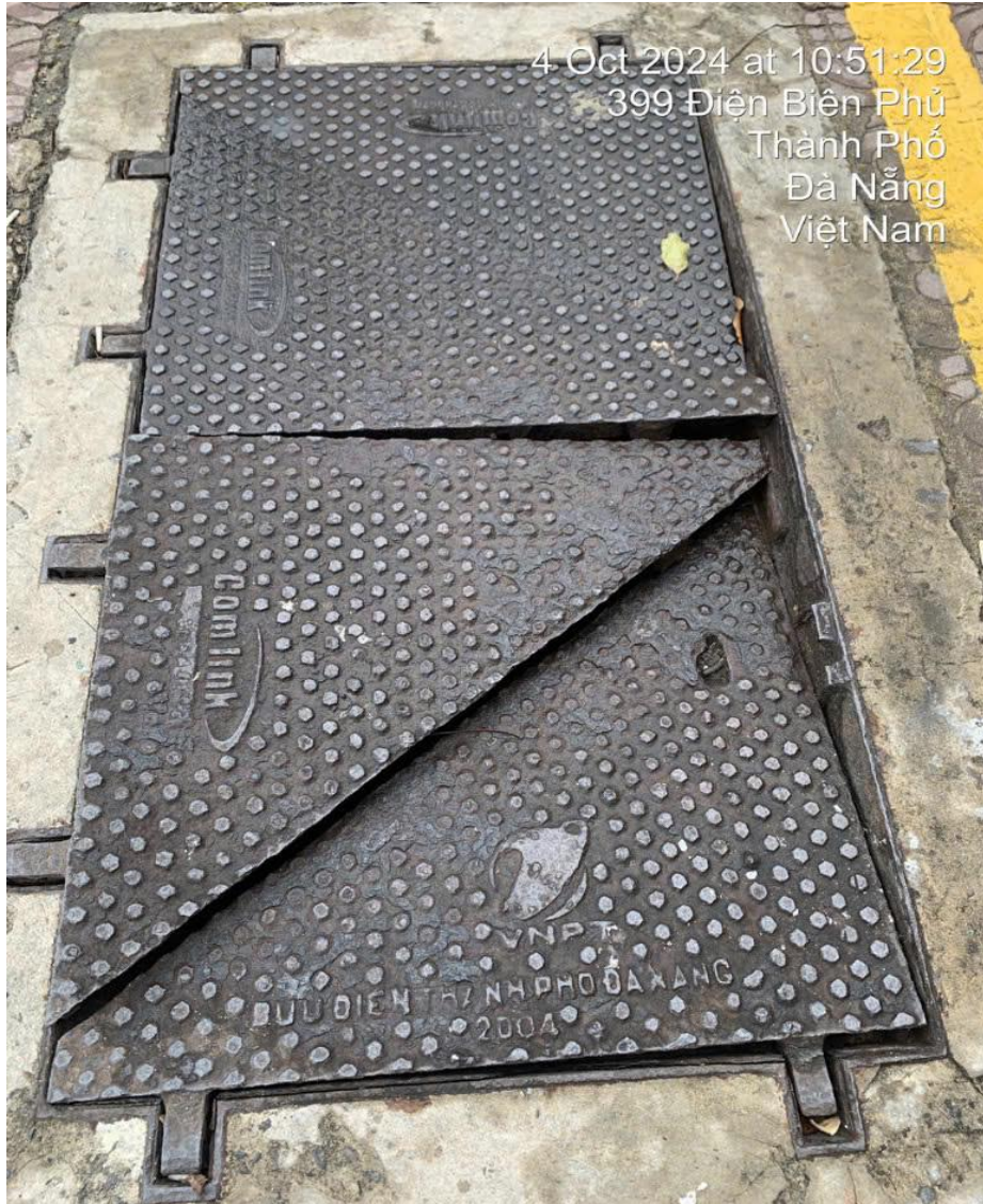
Hình ảnh hố ga bị hỏng của bưu điện đối diện số 395 Điện Biên Phủ
