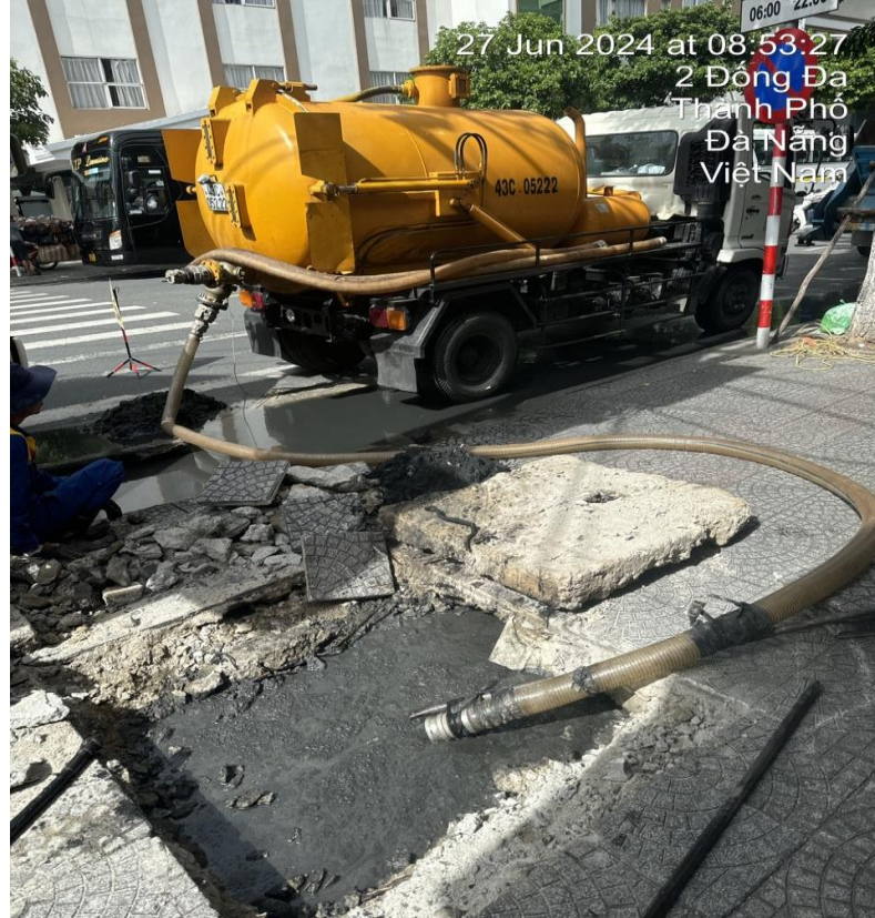
Hình ảnh trước xử lý hố ga thoát nước trước số nhà 02 đường Đống Đa
