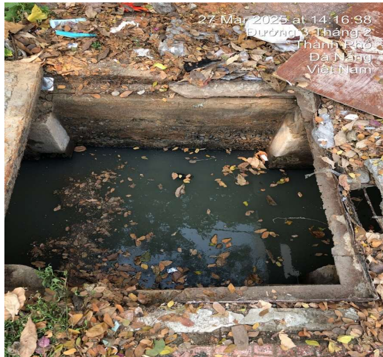
Hình ảnh trước xử lý nắp hố ga gần số nhà 98 đường 3 tháng 2
