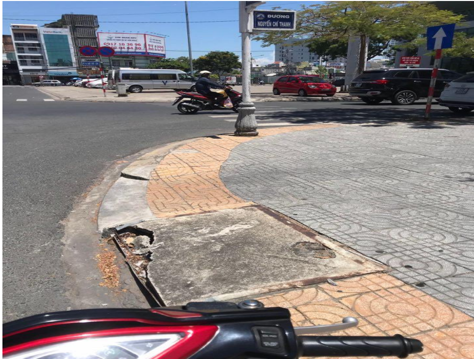
Hình ảnh trước xử lý tại nắp cống bị vỡ góc đường Nguyễn Thái Học – Nguyễn Chí Thanh
