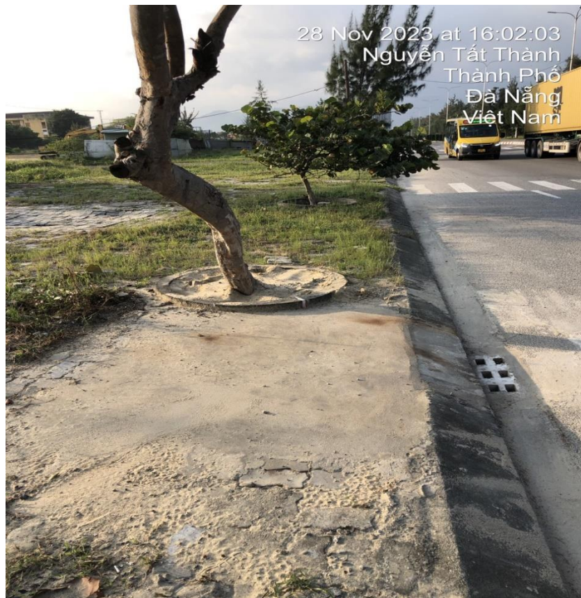
Hình ảnh sau xử lý vị trí sụt lún trên vỉa hè đường Nguyễn Tất Thành
