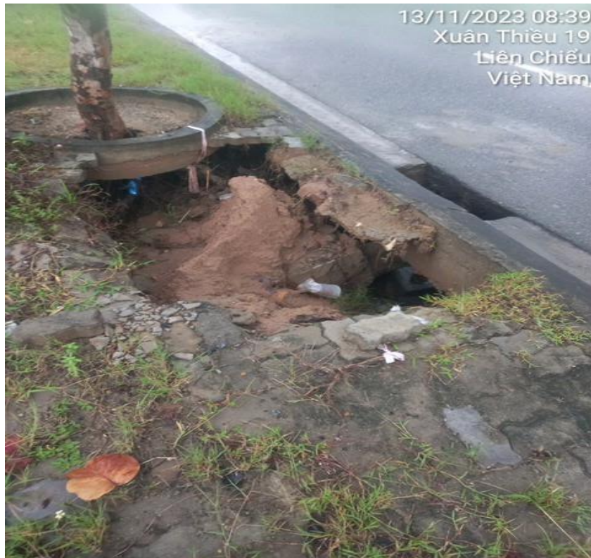
Hình ảnh sụt lún trên vỉa hè đường Nguyễn Tất Thành
