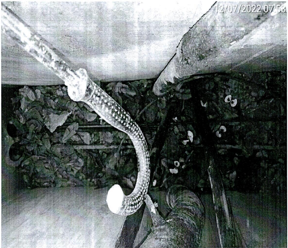
Hình ảnh hổ ga tuyến cáp ngầm trên tuyến đường Yết Kiêu
