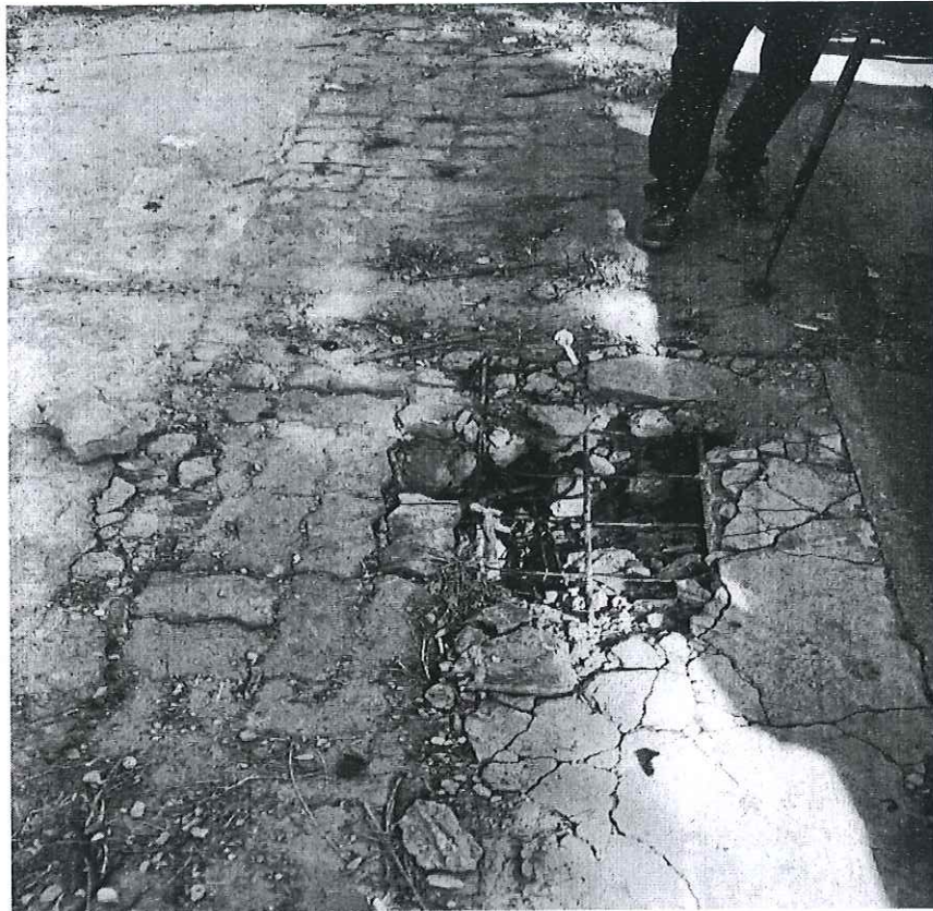
Hình ảnh trước xử lý tấm đan bị vỡ trên vỉa hè đường 3 Tháng 2
