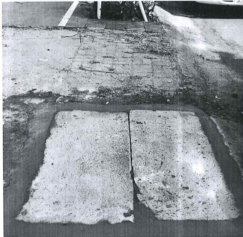
Hình ảnh sau xử lý tấm đan tấm đan bị vỡ trên vỉa hè đường 3 Tháng 2
