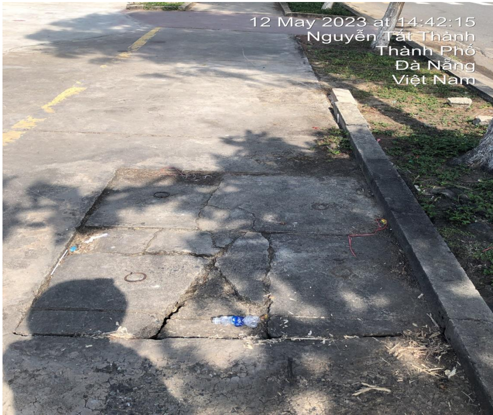
Hình ảnh trước xử lý vị trí nắp hố ga hư hỏng trên đường Nguyễn Tất Thành
