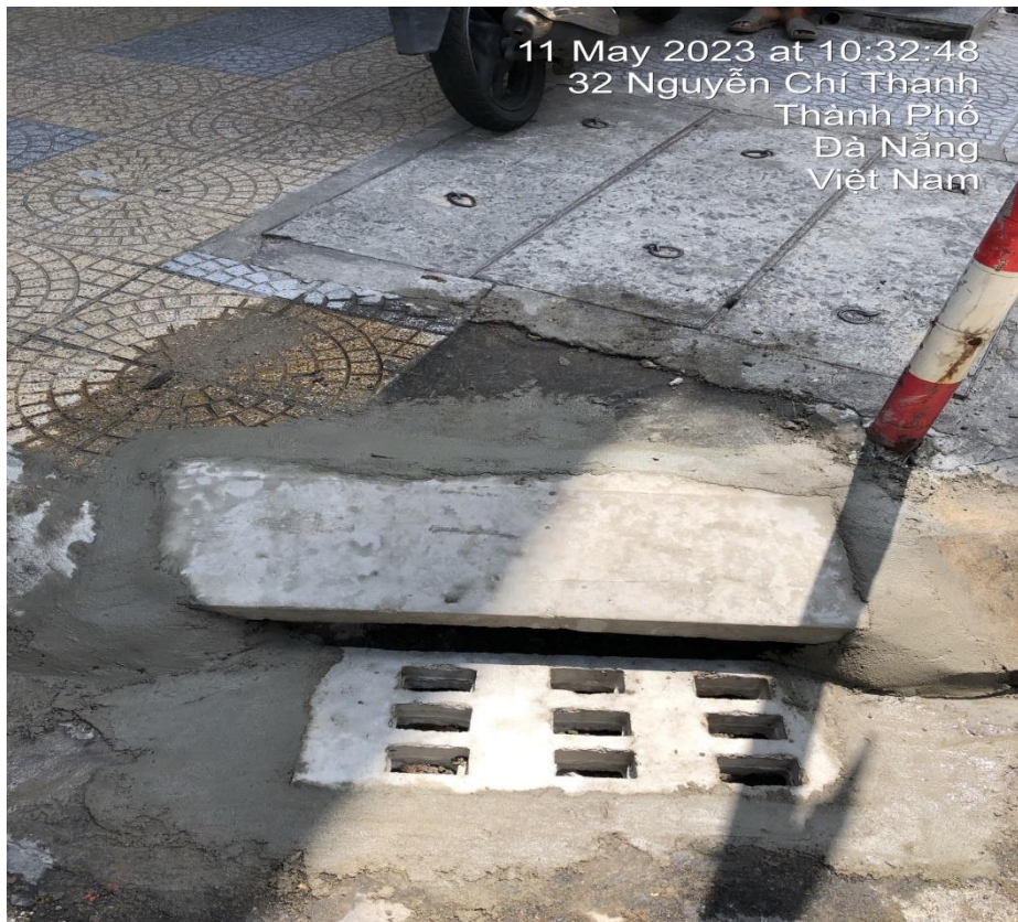
Hình ảnh sau xử lý vị trí bó vỉa hư hỏng trên đường Nguyễn Chí Thanh
