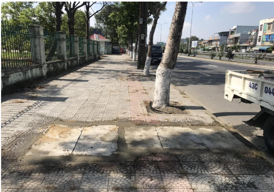
Hình ảnh sau xử lý tại vị trí hố ga bị vỡ trước số 555B Trường Chinh
