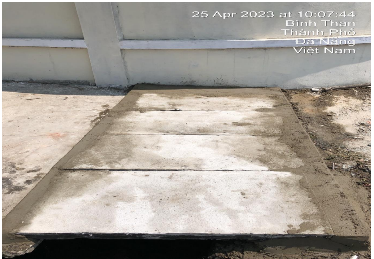
Hình ảnh mương thu nước sau xử lý trên vỉa hè ngã tư Vân Đồn – Bình Than
