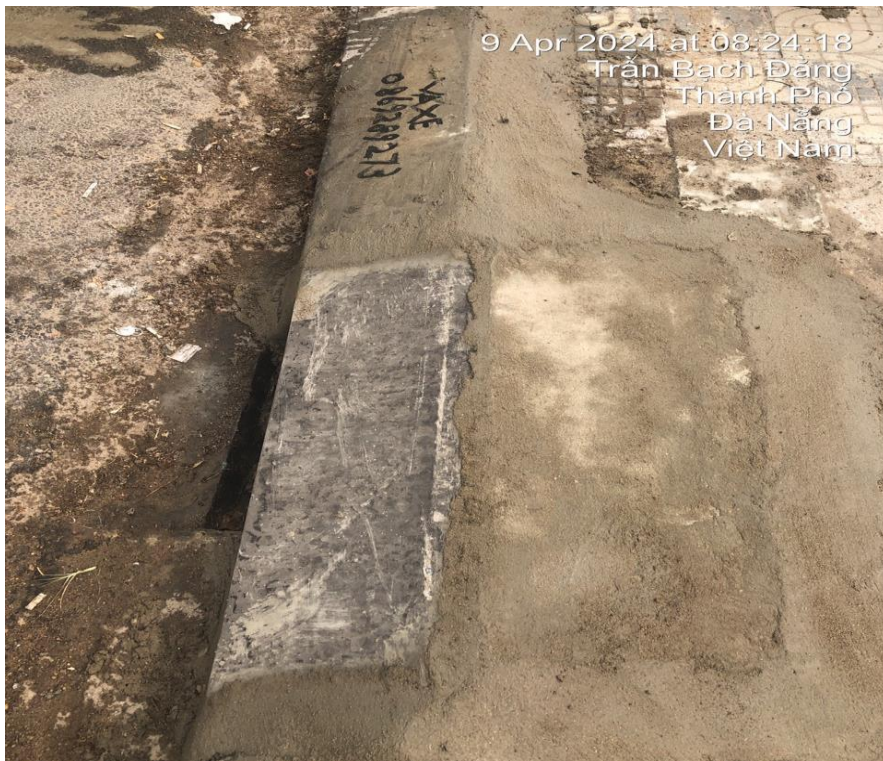
Hình ảnh sau xử lý bó vỉa trên vỉa hè đối diện số 132 Trần Bạch Đằng
