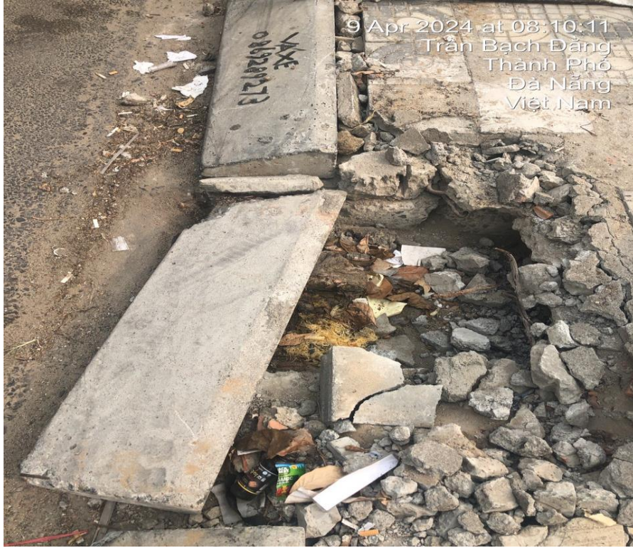
Hình ảnh trước xử lý bó vỉa trên vỉa hè đối diện số 132 Trần Bạch Đằng
